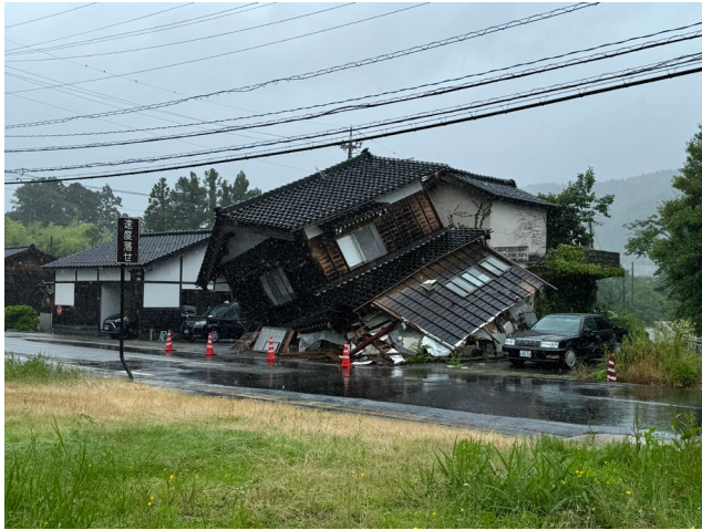
1 階部分が潰れて道路にはみ出すほど被災している家屋
